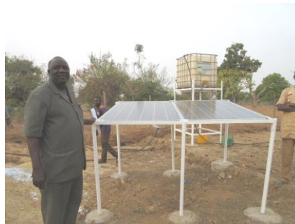
Solarmodul und Wassertank
